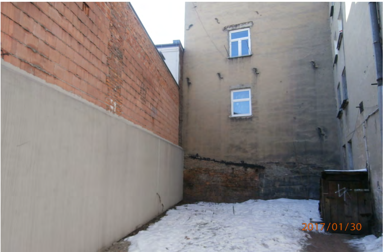
Fot.2 Widok zniszczonego powierzchniowo muru- do naprawy Bud. 4 od północy
